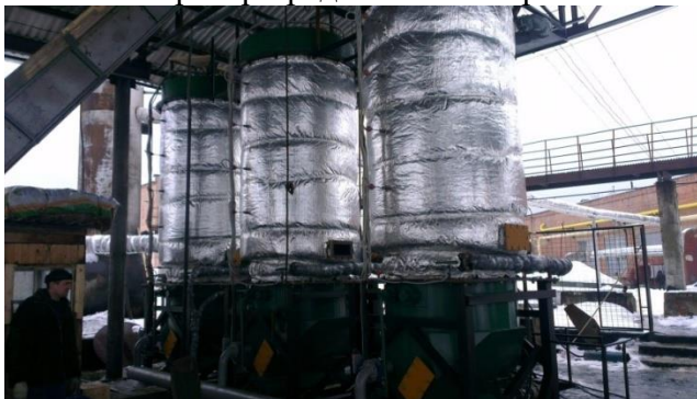
Рисунок 1 – Газогенератор експлуатаційною потужністю 2 МВт (Малинська паперова фабрика) [2].
